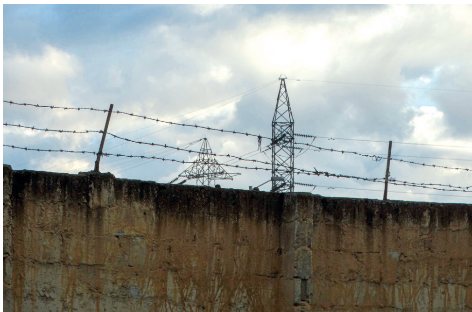
Figura 9. Muro en ruinas entre Ferroaleaciones de Colombia y la Empresa de Energía de Boyacá. Fuente: Autor (2016)
